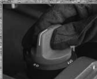
Interruptor de corte de la batería
